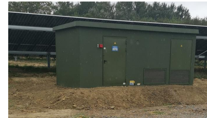
Détail du local technique
